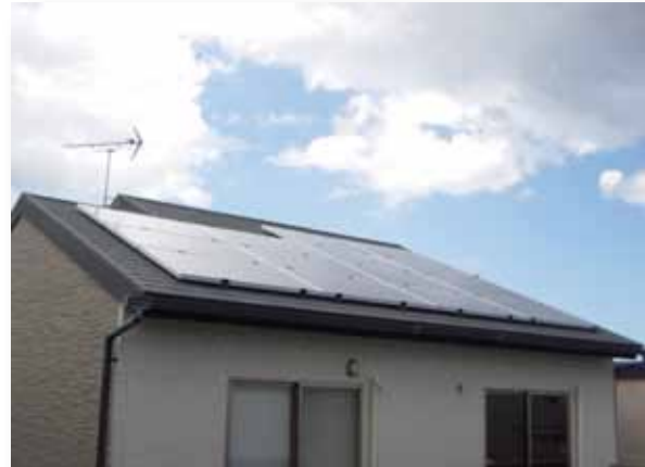
施工後《福岡県F邸 5.5kW》
